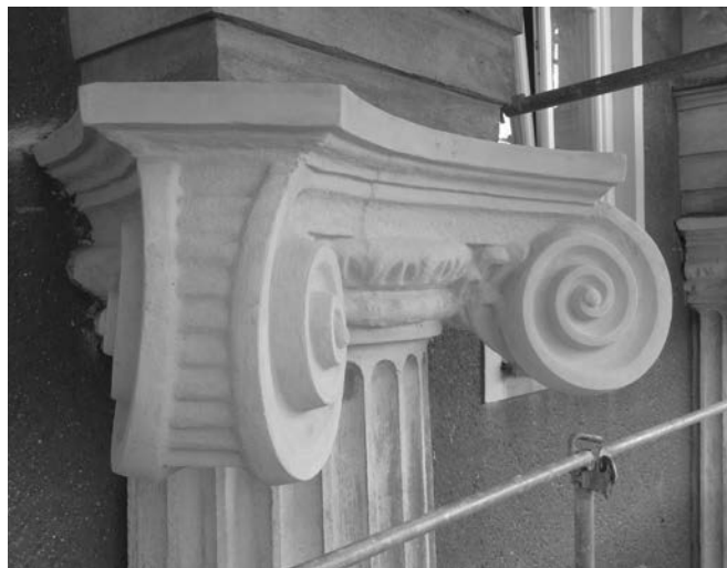
SOUDOBA NÁHRADA POŠKOZENÝCH HLAVIC DEKORATIVNÍCH SLOUPŮ NOVODOBÝMI PREFABRIKÁTY (HLAVNÍ TŘÍDA V PORUBĚ, PODZIM 2015)
